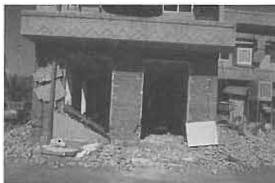
شکل ۱۵. کلاف اجرا شده اما در داخل آن دیواری وجود ندارد
